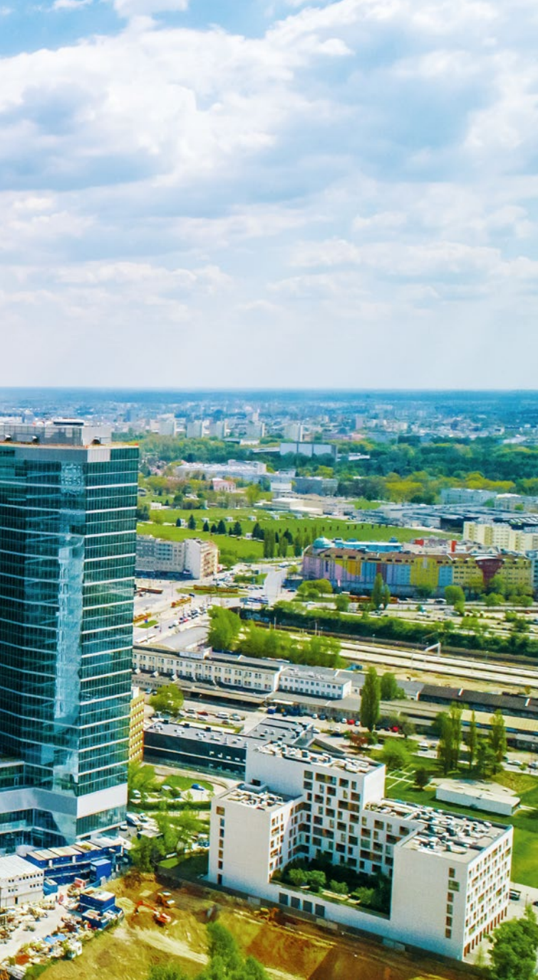
Budowa zespołu budynków biurowych Skyliner przy rondzie Daszyńskiego w dzielnicy Wola w Warszawie. Docelowo wieżowiec ma mieć 195 m wysokości, fot. Warbud SA
