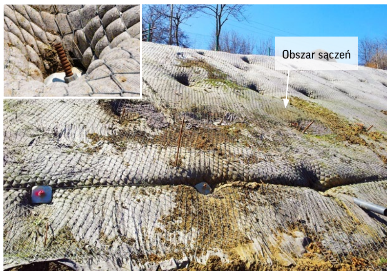
Ryc. 3. Widok ogólny zdeformowanej skarpy gwoździowanej ze szczegółem przeciążonego gwoźdźca gruntowego i siatki stalowej
