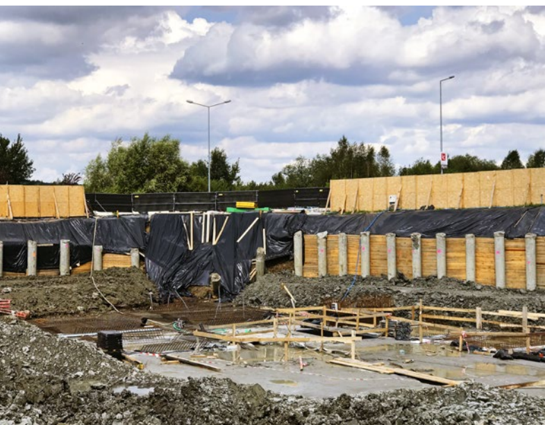
Ryc. 1. Widok zniszczonej konstrukcji ścianki berlińskiej wspornikowej
