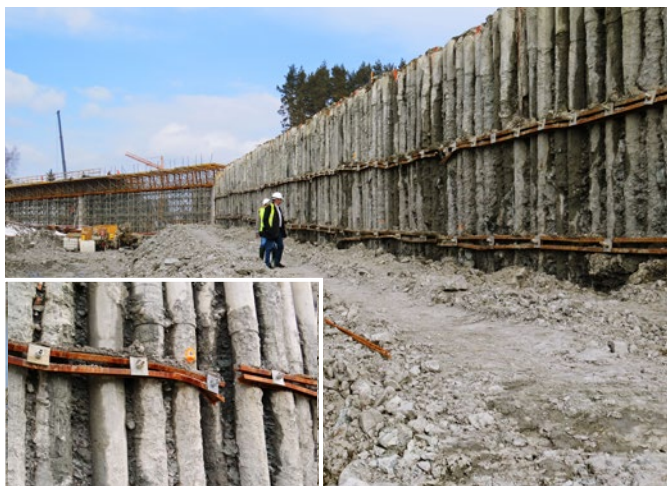
Ryc. 6. Uszkodzona konstrukcja z uformowaną przyporą ratunkową i przeciężony rząd mikropali kotwiących (widoczne deformacje)
