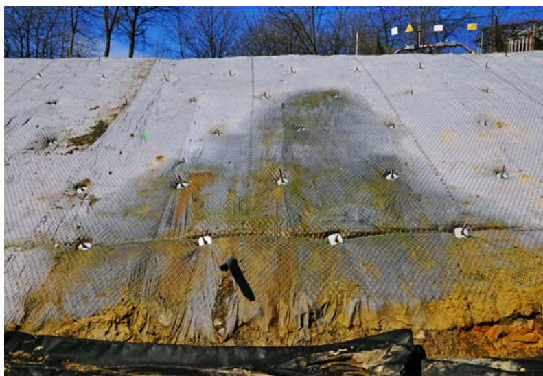
Ryc. 4. Skarpa z widocznymi intensywnymi sączeniami
