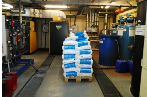
Stacja uzdatniania wody kotłowej i stacja sprężarek
