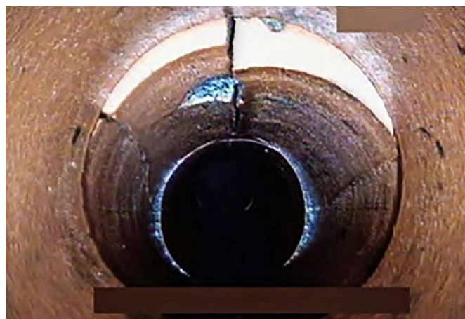
Ryc. 1. Deformacja spękanej rury o konstrukcji sztywnej [4]
