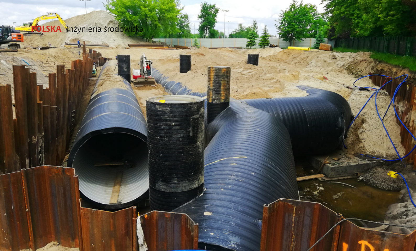
II etap inwestycji – zbiornik Weho SN8 DN 3000 wraz z łukami i trójnikami DN 3000
