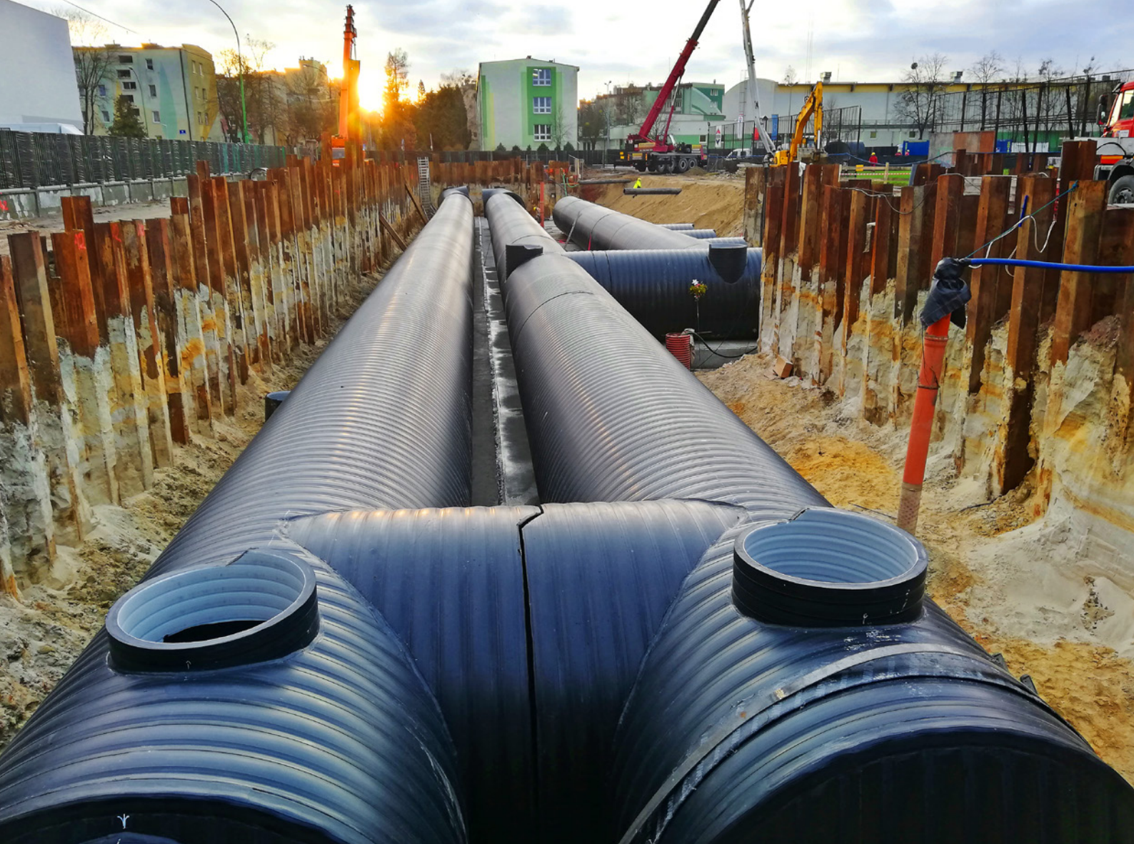
I etap inwestycji – układ równoległych i prostopadłych do siebie zbiorników retencyjnych Weho SN8 DN 2500
