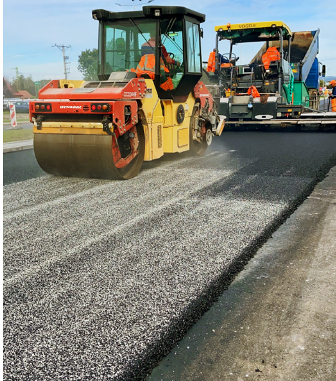
Chcąc uzyskać prawidłowe ułożenie i zagęszczenie nawierzchni z asfaltem MODBIT 45/80-80 HiMA, firma RBDiM Krosno zapewniła płynne dostawy mieszanek mineralno-asfaltowych, bezprzebiegową pracę rozkładarek i walców
