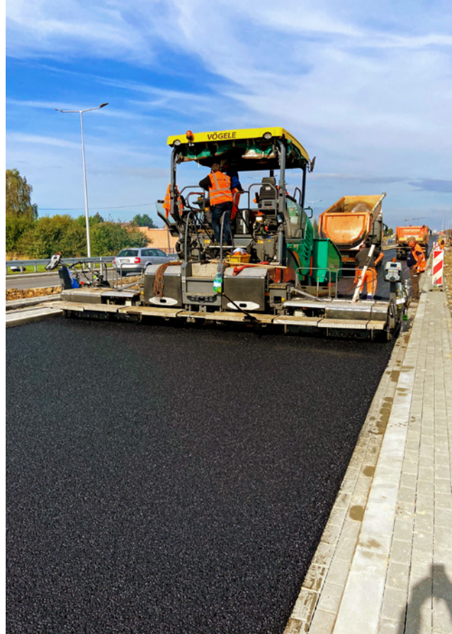
Dobudowa drugiej jezdni obwodnicy Krosna w ciągu DK28. Nowoczesne asfalty modyfikowane MODBIT i wysokomodyfikowane MODBIT HiMA zrewolucjonizowały budowę dróg w zakresie trwałości i odporności na koleinowanie
