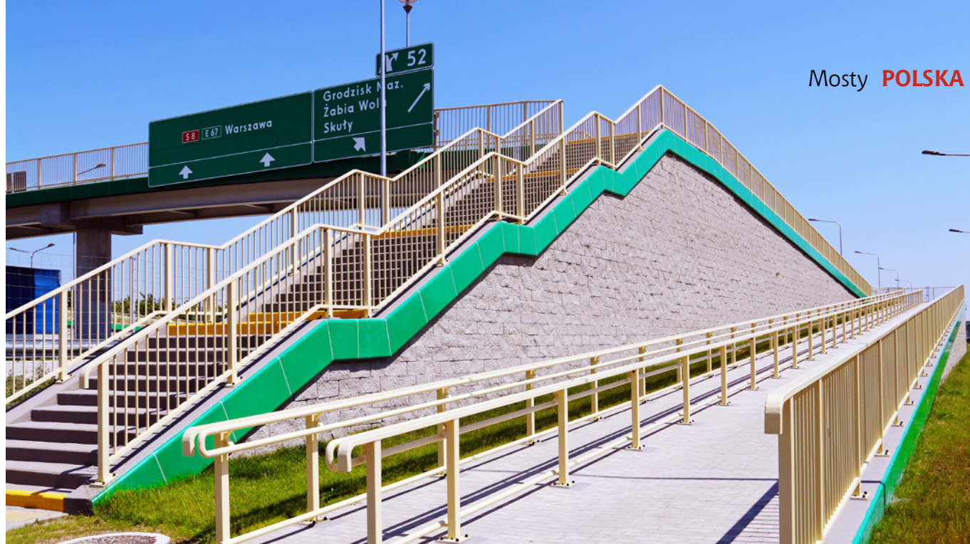
Mury z gruntu zbrojonego z oblicowaniem z bloczków drobnowymiarowych w kładkach dla pieszych
