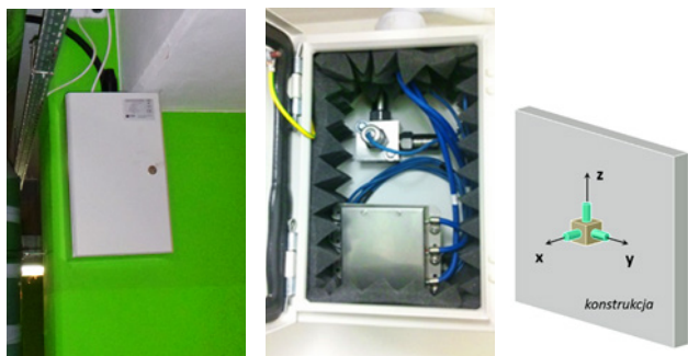
Widok punktu pomiarowego w dyskretnej obudowie, zestawu czujników wewnątrz obudowy oraz schemat położenia czujników na pionowym elemencie konstrukcyjnym (np. ścianie fundamentowej)
