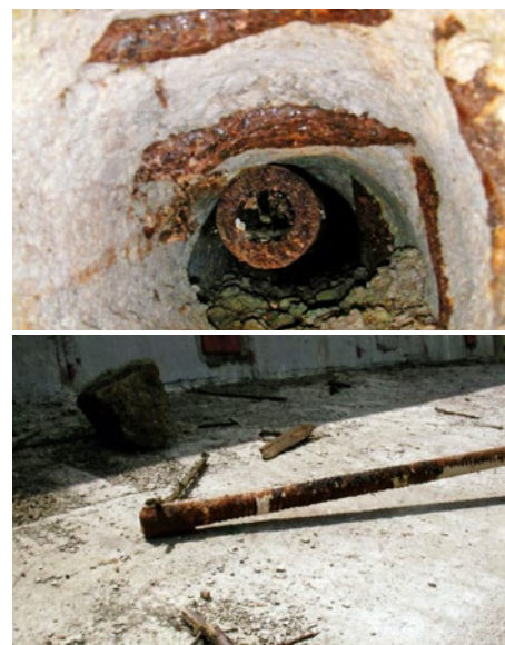
Awaria konstrukcji spowodowana wyrwaniem żerdzi z mufy
