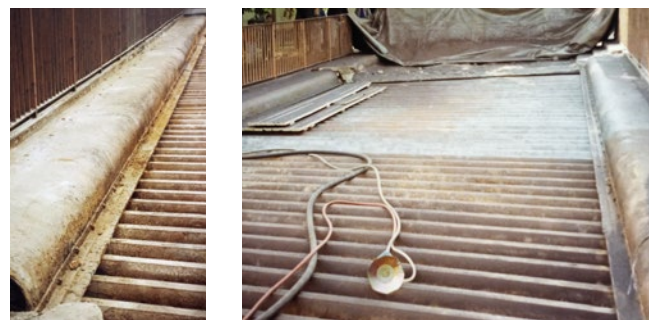
Ryc. 7. Widok prac mających na celu odpowiednie oczyszczenie powierzchni stalowych kształtowników Zoresa przed wykonaniem wzmocniającej płyty żelbetowej. Widoczny szczegół połączenia kapy chodnikowej z pomostem (po lewej) oraz widok zasadniczych prac przygotowawczych z użyciem metody strumieniowo-ściernej
