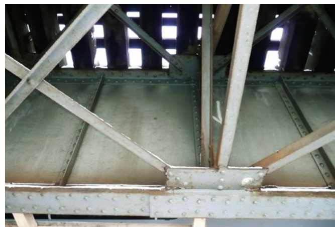
Ryc. 4. Przykład typowego pomostu otwartego mostu kolejowego z zastosowaniem mostownic opartych na dźwigarach blachownicowych. Widoczny nieograniczony wpływ warunków atmosferycznych na poszczególne elementy konstrukcyjne mostu (dźwigary główne, poprzecznice, stężenia itp.)
