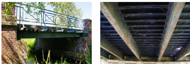
Ryc. 1. Przykład pomostu niewspółpracującego, wykonanego z kształtowników Zoresa, ułożonych bezpośrednio na stalowych dźwigarach głównych. Widoczne dodatkowe wykorzystanie kształtowników w celu mocowania balustrady (zdjęcie po lewej) oraz widok konstrukcji pomostu od spodu
