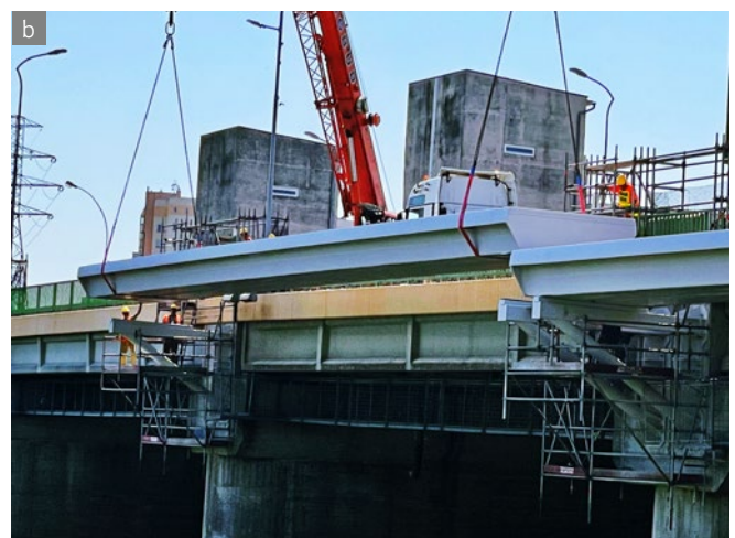
Ryc. 4. Montaż konstrukcji kompozytowej: a) transport konstrukcji; b) montaż przęsła na podpory za pomocą dźwигów
