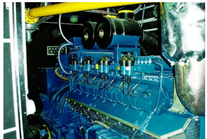
Silnik jednostki kogeneracyjnej
