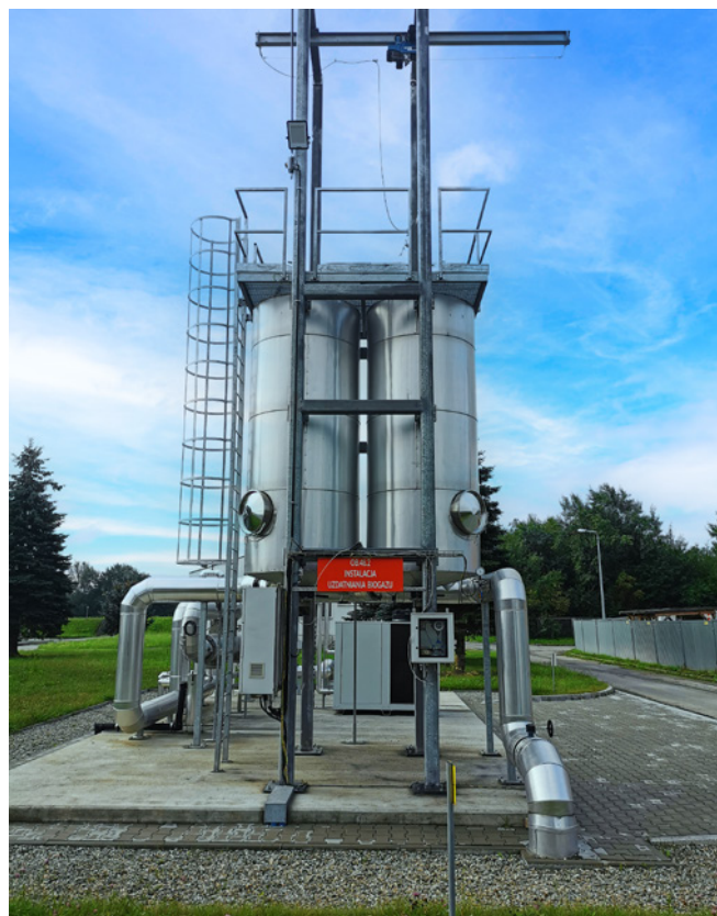
Ryc. 5. Instalacja uzdatniania biogazu
