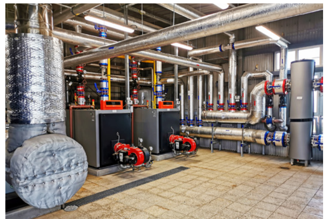
Ryc. 9. Nowe kotły kondensacyjne
