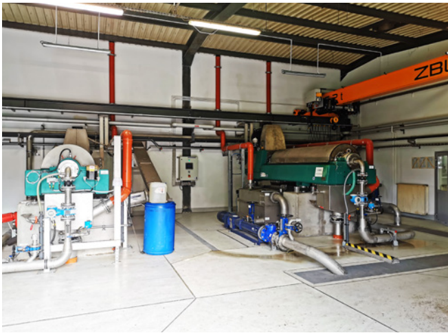
Ryc. 2. Wirówki zagęszczająca (po prawej) i odwadniająca
