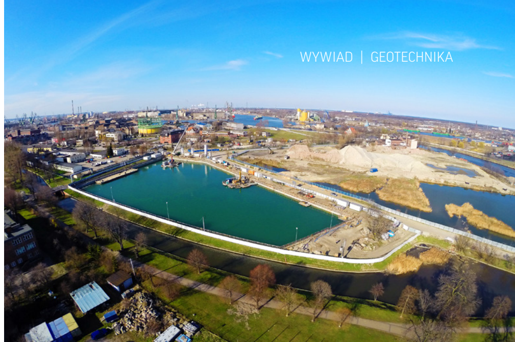
Budowa Muzeum II Wojny Światowej w Gdańsku, zabezpieczenie płyty dennej przed wyporem mikropalarni
