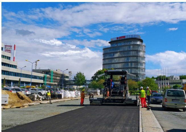
Remont nawierzchni parkingu Rafinerii Gdańskiej Sp. z o.o. z wykorzystaniem granulatu asfaltowego z recyklingu nawierzchni
