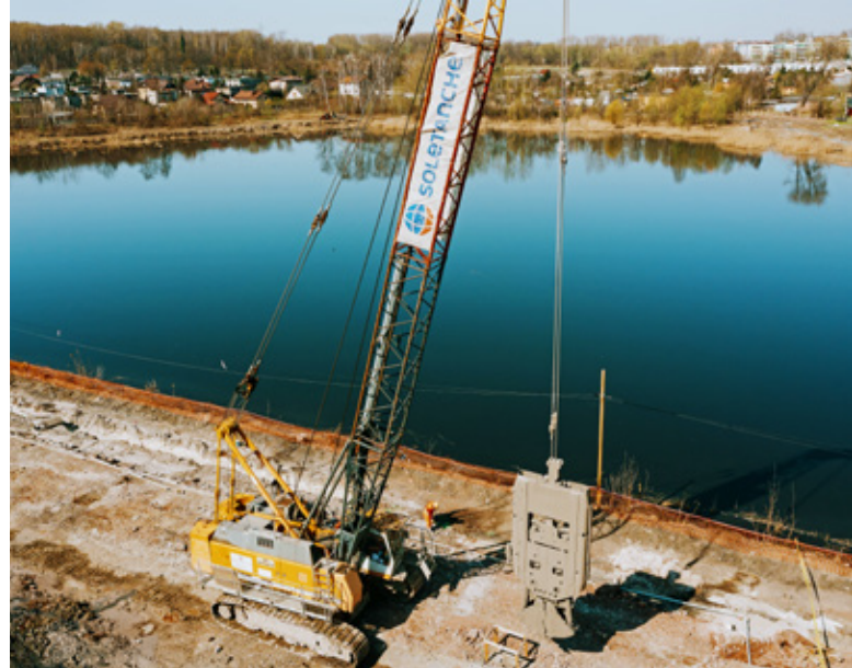
Realizacja pionowej przesłony przeciwfiltracyjnej, staw Kalina, przesłona kopana w technologii slurry trench, archiwum Soletanche Polska
