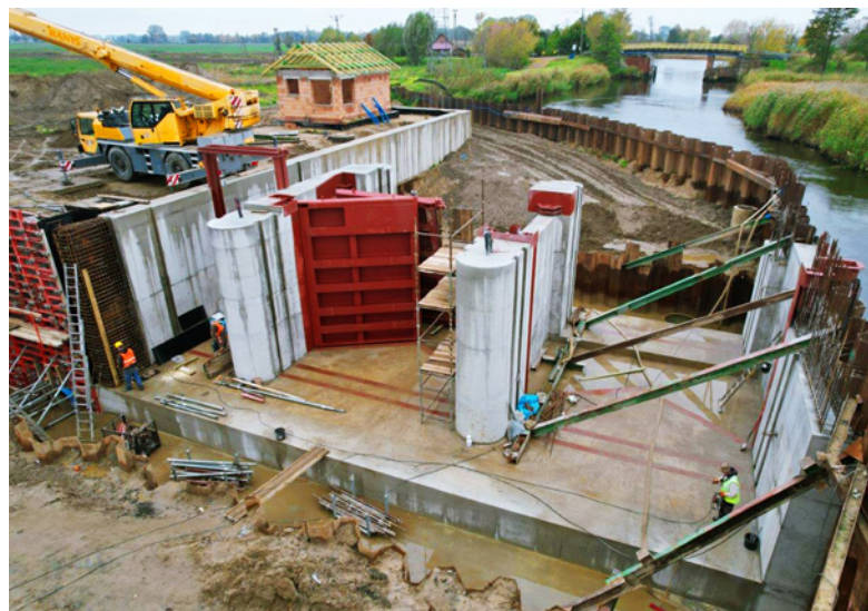
Pod koniec 2022 r. Wody Polskie zakończyły projekt o nazwie Kompleksowe zabezpieczenie przeciwpowodziowe Żuław – etap II . Jego celem była odbudowa i modernizacja systemu ochrony przeciwpowodziowej. W ramach projektu zrealizowano m.in. odbudowę 19 ostróg na Wiśle, przebudowę stopnia wodnego Przegalina, budowę wrót sztormowych na rzece Tudze, fot. Wody Polskie
