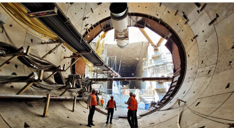
Widok na komorę tunelu w Łodzi, fot. M. Siemieniec, PKP PLK S.A.
