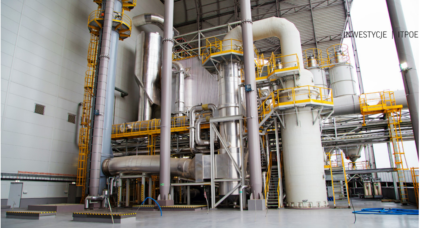
Instalacja oczyszczania spalin w ITPOE I, PGE Energia Ciepła Oddział Elektrociepłownia w Rzeszowie
