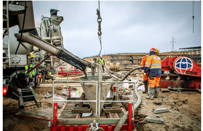
Budowa ITPO w Olsztynie, realizacja ścian szczelinowych, betonowanie sekcji, widok z boku, fot. Ireneusz Rek, archiwum Soletanche Polska
