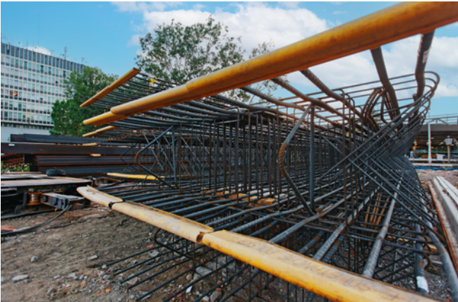
Stacja Warszawa Zachodnia, przykład koszy zbrojeniowych wykorzystywanych do wzmocnienia ścian szczelinowych, fot. Tomasz Stępnik
