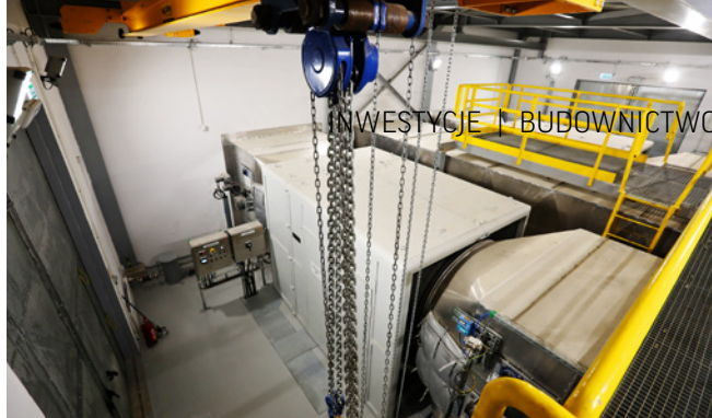
Wnętrze zmodernizowanej stacji wentylatorów Wilson
