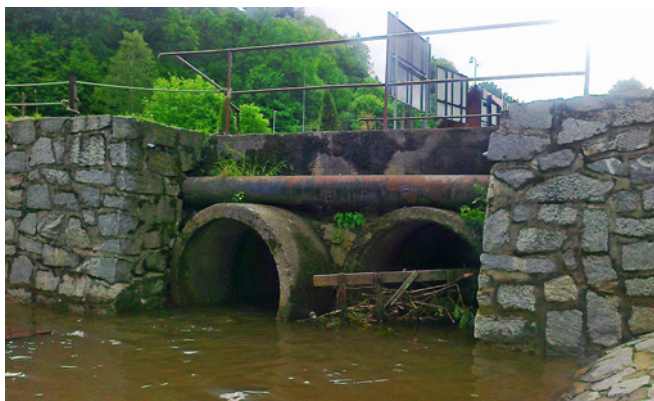
Ryc. 11. Przykład przepustu dwuotworowego z ograniczonym światłem jednej z rur osłonowych powodującym częściowe spiętrzenie wody na wlocie przepustu, fot. A. Wysokowski
