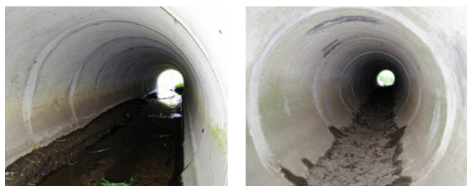
Ryc. 9. Przykłady osadów w postaci materiału mineralnego stanowiącego podstawowe zagrożenie dla trwałości dna i parametrów przepływu w betonowych rurach osłonowych przepustów komunikacyjnych, fot. A. Wysokowski
