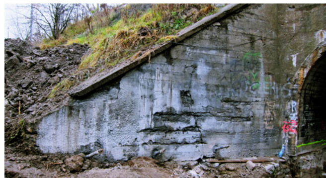
Ryc. 4. Przykład degradacji warstwy przypowierzchniowej skrzydła żelbetowego. Widoczne charakterystyczne regularne ubytki otuliny betonowej na skutek obniżenia pH betonu i oddziaływania produktów korozji prętów zbrojeniowych, fot. A. Wysokowski
