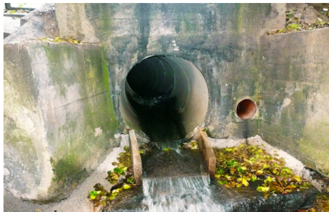
Ryc. 8. Przykład turbulentnego przepływu wody przez przepust betonowy. Widoczne lokalne uszkodzenia na skutek abrazji dna rur osłonowych (widoczne szare przebarwienia), fot. J. Howis
