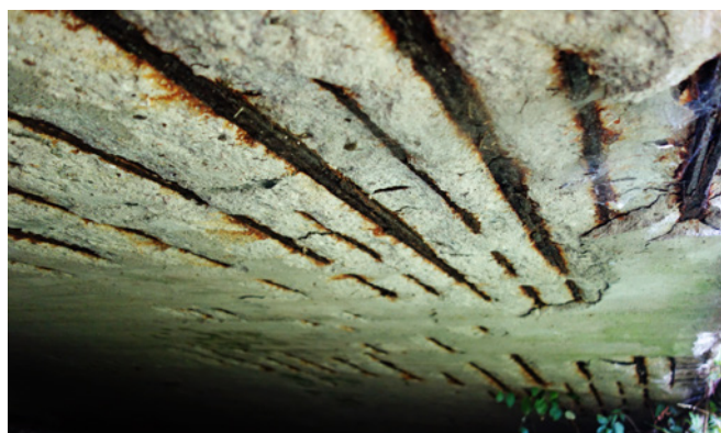
Ryc. 3. Przykład odsłoniętych i skorodowanych prętów zbrojeniowych stropu przepustu żelbetowego na skutek obniżenia pH betonu, fot. A. Wysokowski
