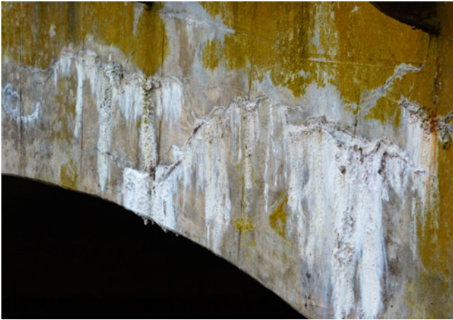
Ryc. 6. Przykład skrajnego efektu wytrącania się produktów pasywacyjnych na powierzchni betonowej przepustu drogowego. Widoczna degradacja i obniżenie estetyki powierzchni betonowej przy jednoczesnym doszczelnieniu powstałych spękań na skutek tzw. autogenicznego gojenia – doszczelnienia spękań produktami reakcji chemicznych, fot. A. Wysokowski
