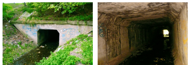
Ryc. 7. Przykład przecieków agresywnej wody przez ściany i strop konstrukcji drogowego przepustu skrzynkowego na skutek wieloletniego oddziaływania wód gruntowych (obiekt znajduje się w lokalnym zagłębieniu terenu), fot. J. Howis
