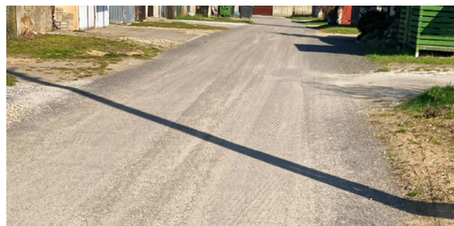
Ryc. 5. Nawierzchnia odcinka testowego po dziewięciu miesiącach od oddania odcinka do eksploatacji
