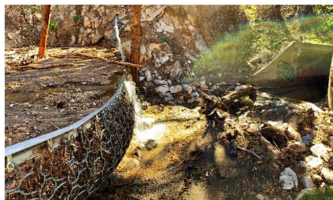
Ryc. 2. Wypełniona bariera przeciwrumowiskowa z odpływem poniżej
