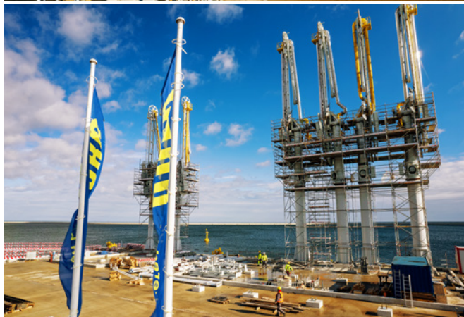
Rozbudowa części morskiej terminala regazyfikacyjnego skroplonego gazu ziemnego w Świnoujściu, 2020–2024, zamawiający: Zarząd Morskich Portów Szczecin i Świnoujście SA, fot. archiwum PORR SA
